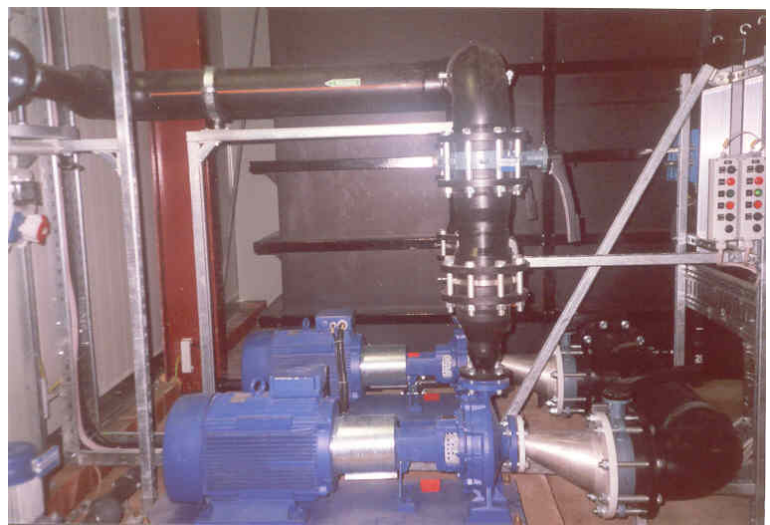
Reinwasserpumpen in der Leichtbauhalle
